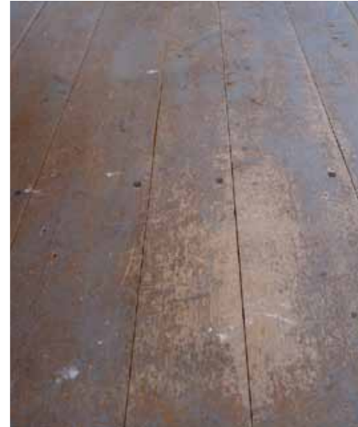
Golv frå 1890-talet i hus på garden Berglund i Målselv. Slitasjen i målinga seier oss at det har vore meir trafikk i akkurat dette området. Foto: Roald Renmælmo.
